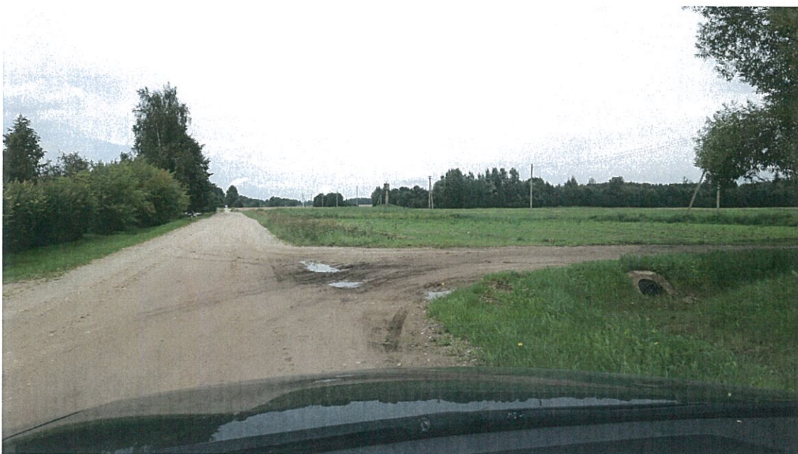
2 Pav. Nagrinėjamos kelio ruožo techninė būklė
